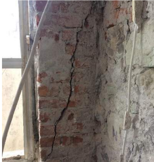
Şekil 9: Yapı Dış Duvarlarında Oluşan Çatlak
